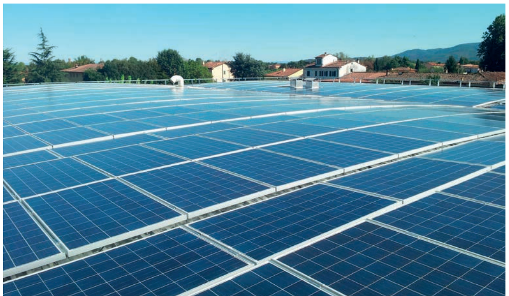
Finergreen a accompagné Smart Energies dans le refinancement de 29 centrales solaires
